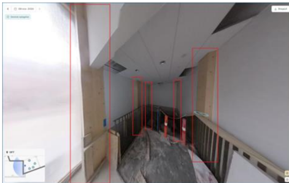
Figur 13-13 Træstøjlere i flugtvejstrappe
